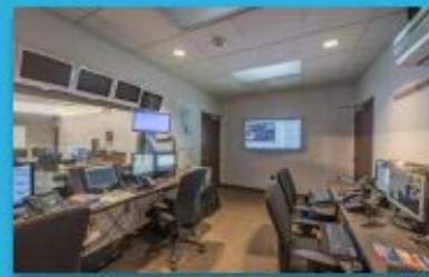
AV Control Room
